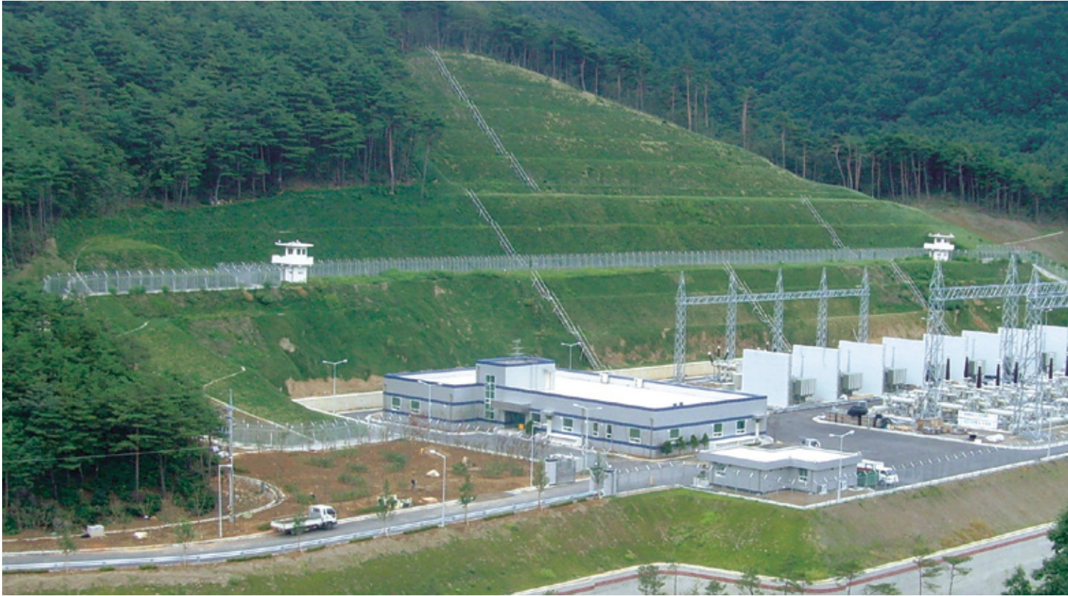
신양양 345kv 공사 Substation 345KV, Sinyangyang Project
