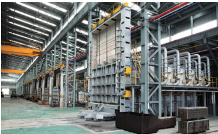
가열로 설비 Heating Furnace
